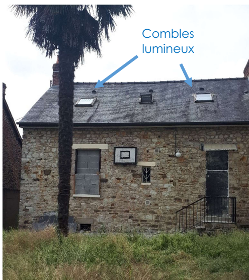
Absence de cavités et de nids d'hirondelle sous les débords de toits
